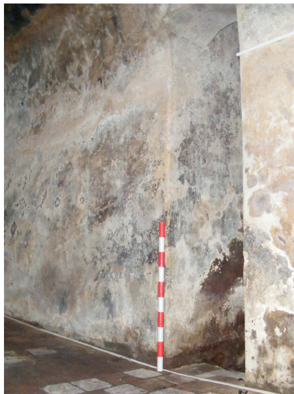
Figura 4. Vista de la abertura lateral de la cisterna en la que se ubican el decantador en la base y brocal en parte superior (hoy inexistente).
