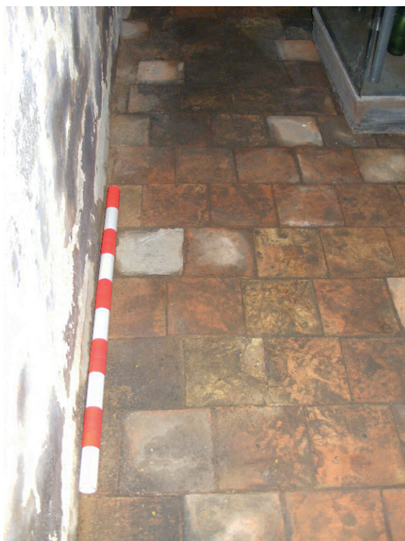
Figura 3. Vista interior de la cisterna en la que se aprecia el piso forrado con baldosas cerámicas.
