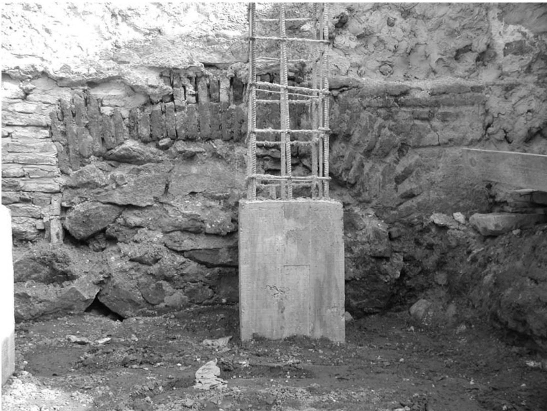
Figura 4: Cimentación con arcos en ladrillo tapiada con piedras hacia fines del siglo XIX / principios del siglo XX.
